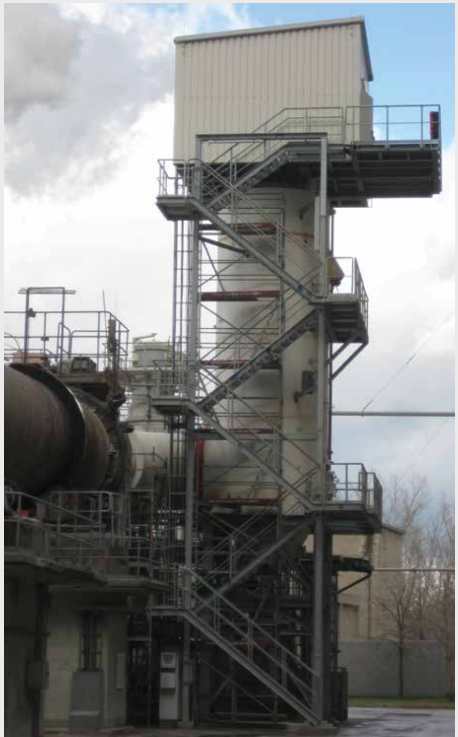
2. GENERATORE DEL GAS CALDO PER L'ESSICCATORE DI CLINKER HOT GAS GENERATOR FOR THE CLINKER DRYER
